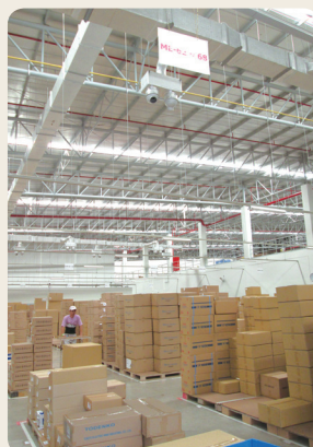
工場の屋根に設けられたスカイライト
