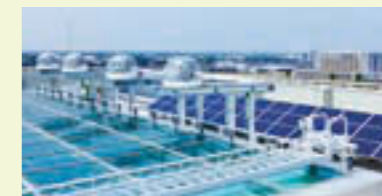
屋上に設置したソーラー パネルと自然光を屋内に 取り込むための太陽光自動 追尾装置
